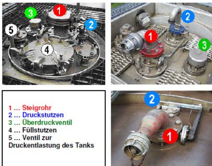
Abbildung A-05 – Armaturen im Dombereich eines Chemiekessels
