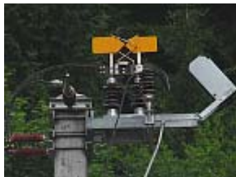
Erdungsschalter Stellung „geerdet“
