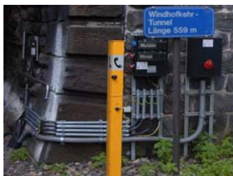
Notruffernsprecher am Portal
