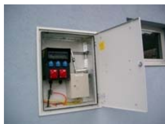
Einbaukasten am Technikgebäude
