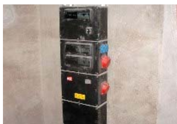
Elektrant in einer Rettungsnische
