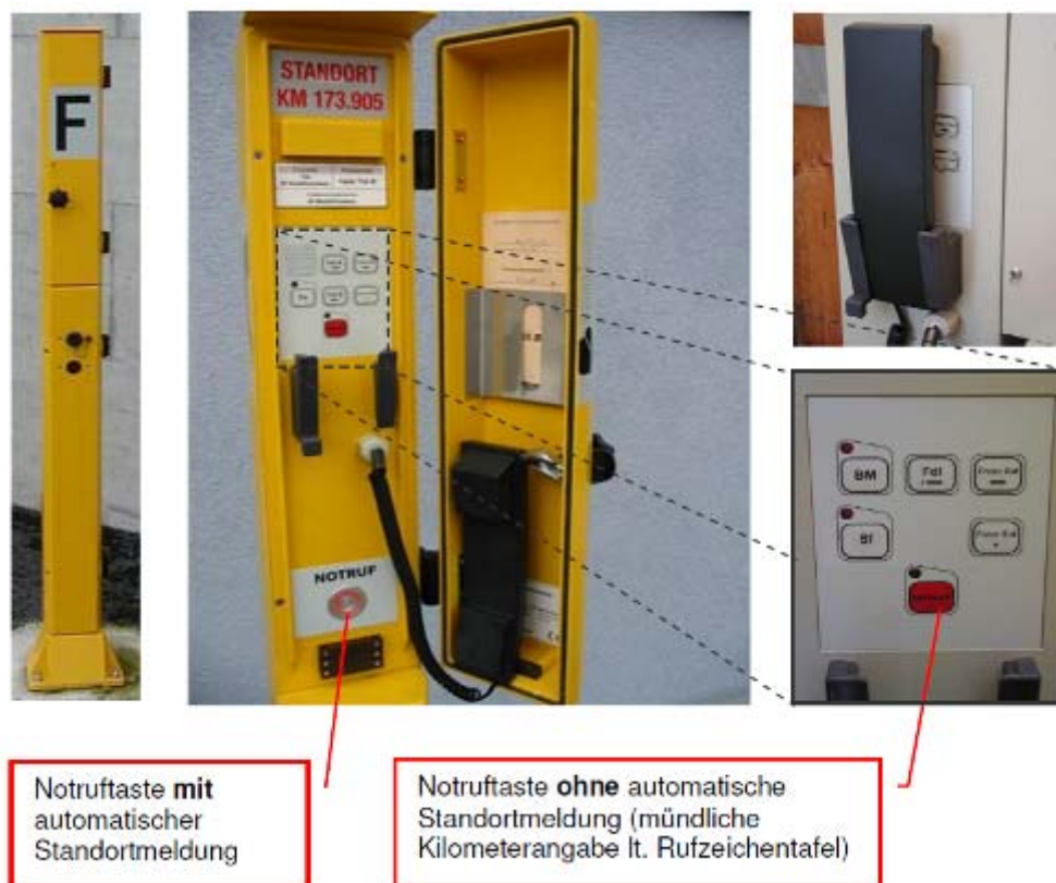
Abbildung 6.14 – Sprechstellen neuerer Bauart
